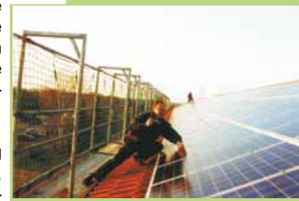
Bürgersolaranlage am Dach der Altenfurter Schule
